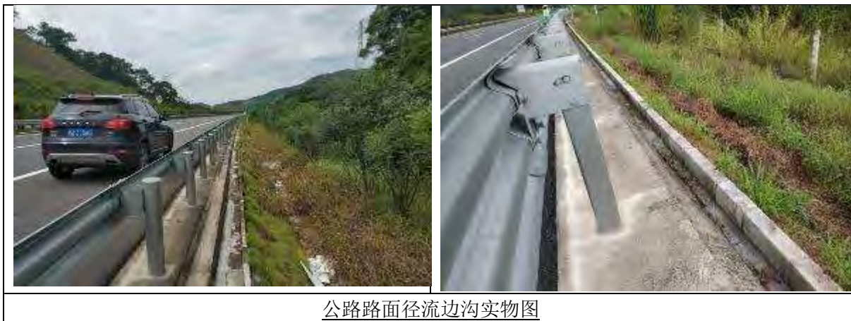
图5.5-1 典型桥面、路面径流收集系统实物图
